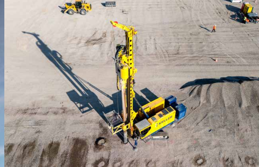
Plaatsing grindkolommen bij de bouw van het XXL-warehouse EVO Park Weert. (Beeld: MVL Media Groep)
